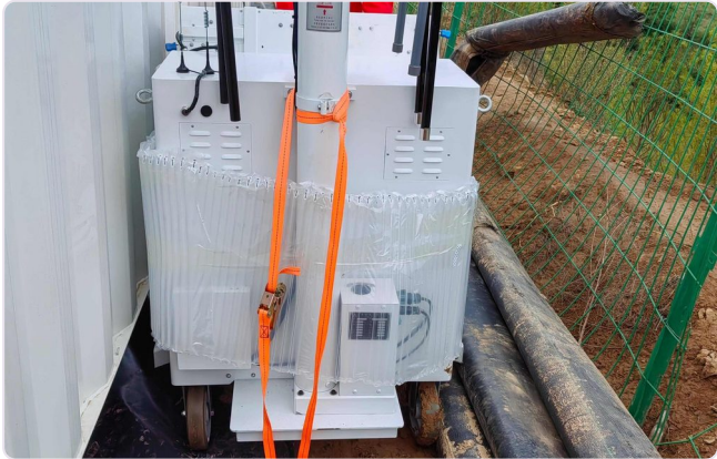
撬装方舱 · 现场部署实拍
